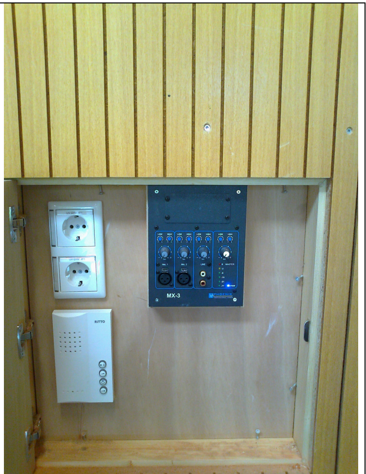
Bild 3: Gegensprechanlage und Musikeinspeisevorrichtung für die Dreifachturnhalle und Gymnastikhalle
